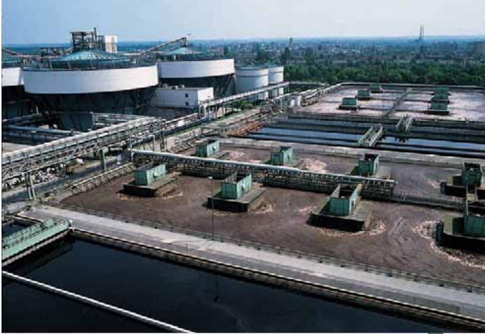
محة تنقية في ألمانيا. يتح حوض الترسيب تنقية المياه من خلال تركيبها، قبل أن تنتقل جزينات الرواسب إلى أجهزة الطرد المركزي.
