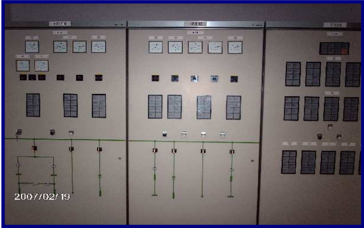
الصورة توضح لوحة التحكم والمراقبة لمحطة التعويض
